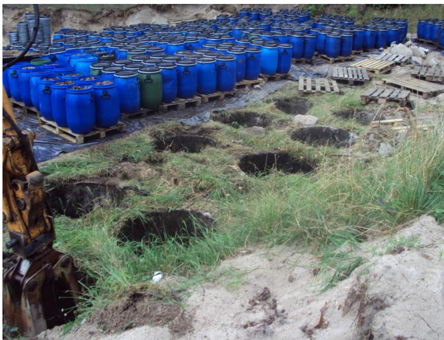
Fotografia III.1.2. Proces likwidacji mogilnika w miejscowości Modrzewo, gmina Suchań (źródło: Urząd Marszałkowski Województwa Zachodniopomorskiego)
